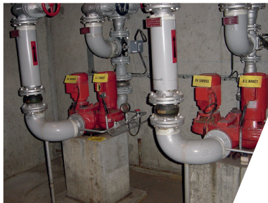
Installation thermique collective d'une résidence
